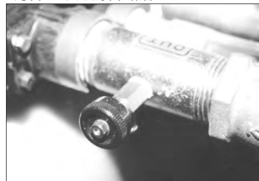
（写真-25）処理水出口配管のサンプリングバルブ
