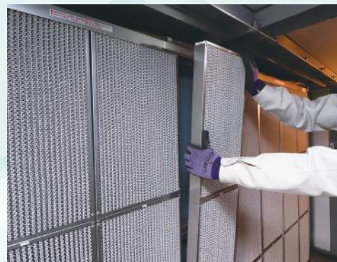
空調機内の加湿モジュールと現場作業
