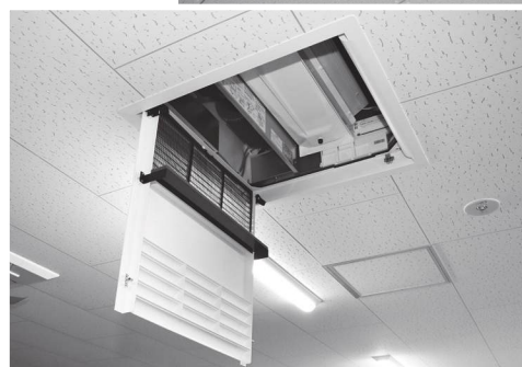
加湿器本体内部
