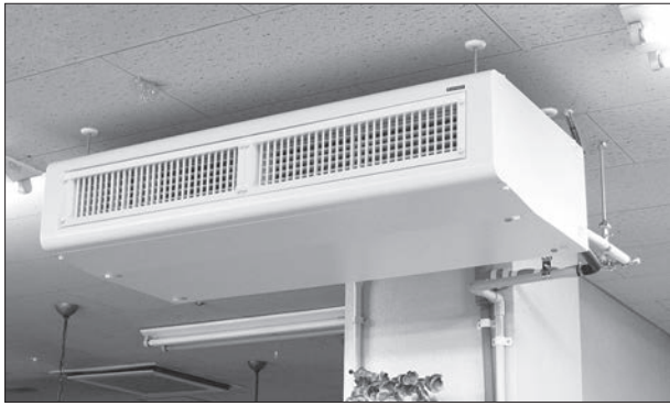
天井付近に取り付けられた滴下浸透気化式 /VTD タイプ
