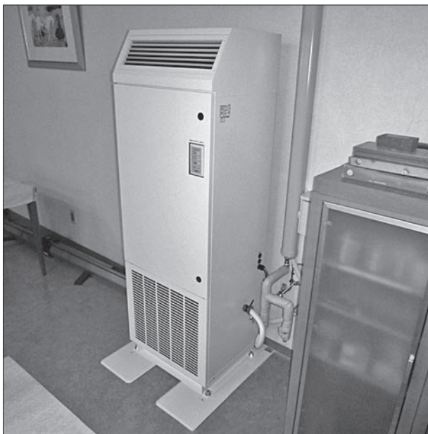
老健施設に取り付けられた滴下浸透気化式 /VWB タイプ
