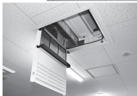
加湿器本体内部
